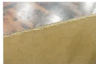
「カラスの足跡」と呼ばれる断裁面の割れ。従来機では頻繁に発生し、品質低下の一要因となっていた
